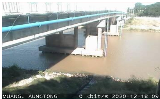
MUANG, AUNGTONG 0 kbit/s 2020-12-18 09: สถานีศาลากลางอ่างทอง ต.บางแก้ว อ.เมือง จ.อ่างทอง (ลุ่มน้ำเจ้าพระยา)
